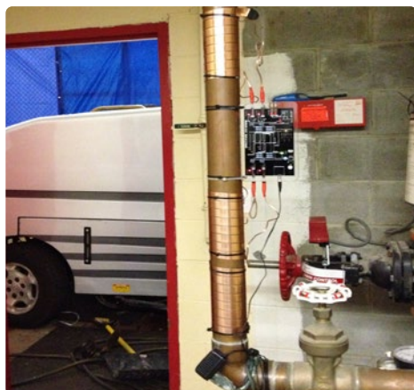
Vulcan S25 installé chez Ice Land dans le New Jersey, USA
