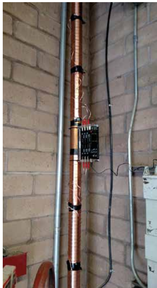
Vulcan S100 installé pour traiter l'eau de la conduite principale
