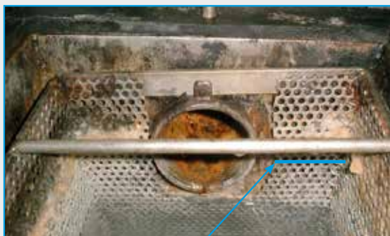
Niveau habituel de l'eau stagnante.
