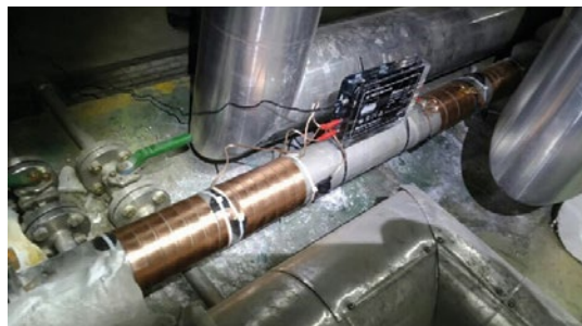
Vulcan S25 installé chez Toray Industries
