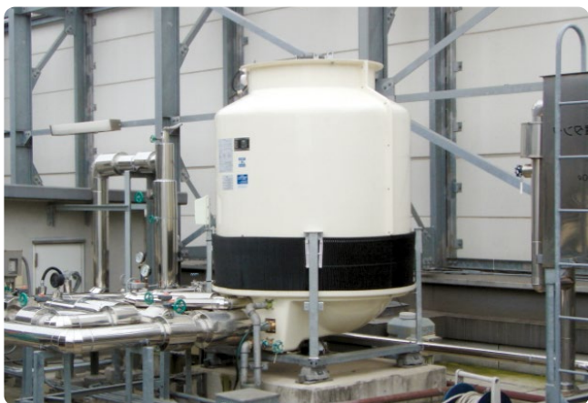
Tour de refroidissement
