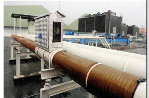
Vulcan S500 se trouvait dans un boîtier en aluminium installé sur l'une des conduites principales de la tour de refroidissement dans Supermal Karawaci.
