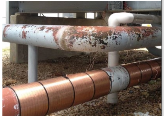
Vulcan S250 a été installé sur une ligne de 10 pouces de diamètre servant à alimenter les deux tours de refroidissement (CT-1 et CT-2)
