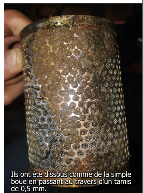
2 mois après l'installation de Vulcan, calcaire et rouille se sont amollis pour devenir des boues.
