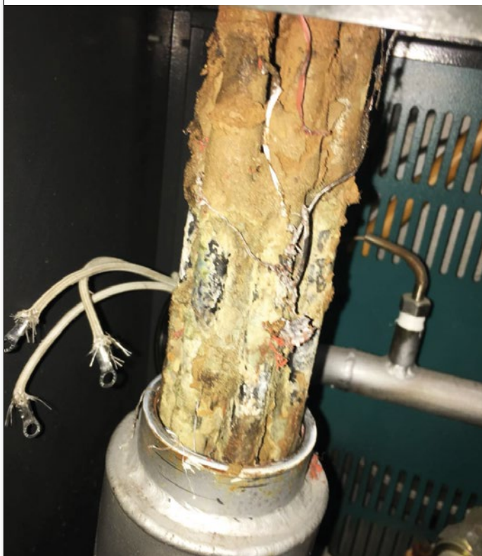
Échangeur de chaleur non traité pendant 3 ans.
