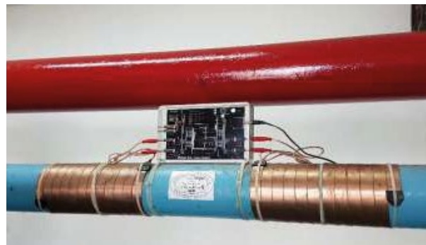
Le dispositif anti-calcaire électronique Vulcan S25 installé
