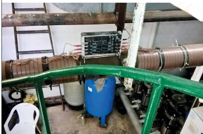
2 Vulcan S100 ont été installés.
